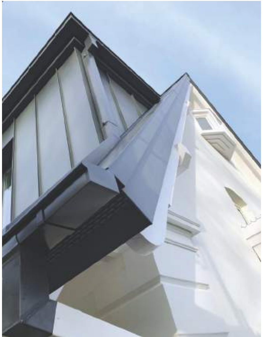
Der Wunsch des Bauherrn nach einer ökologisch wertvollen Sanierung für sein Mehrfamilienhaus wurde mit einem kreativen und langlebigen Metalldachsystem 1:1 umgesetzt.
