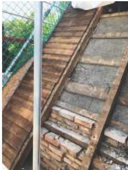
Bei den Abrissarbeiten zeigten sich große, ungedämmte Dachbereiche und viele zahlreichen Sparren waren abgesackt oder verzogen.
