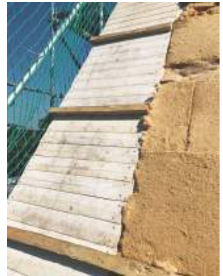
Für den von der Deckunterlage bis zum Innenraum neu erstellten Dachaufbau wurde eine bauphysikalische sichere Metalldachkonstruktion mit Hinterlüftungsebene und Holzfaserdämmstoffen umgesetzt.
